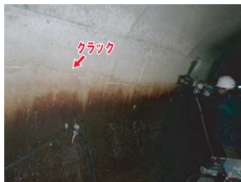
躯体のスプリングラインへのクラック
